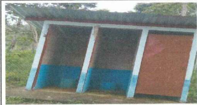
Foto 4: Se aprecia que el baño no cuenta con las condiciones adecuadas para el uso de la comunidad educativa.
