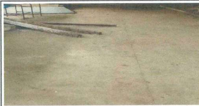
Foto 3: Se observa que la torta de concreto se encuentra en mal estado, presentando signos de deterioro que pueden afectar la estabilidad y resistencia de la infraestructura.
