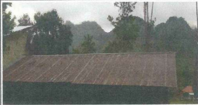
Foto 1: Se ha identificado el deterioro de la cubierta de láminas, lo que ha generado filtraciones de agua durante la época de lluvias.
