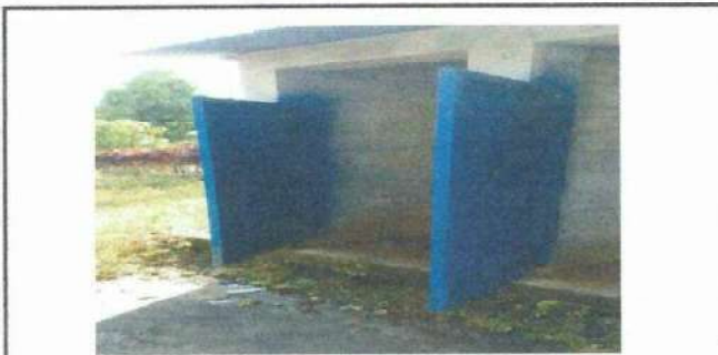
Foto 5: Se observa que las puertas del centro educativo se encuentran en mal estado, presentando desgaste en el metal debido a la exposición constante al agua y la humedad.
