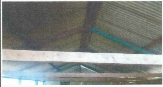
Foto 2: Se observa que la estructura del techo se encuentra en mal estado, lo que compromete la seguridad y estabilidad del establecimiento.
