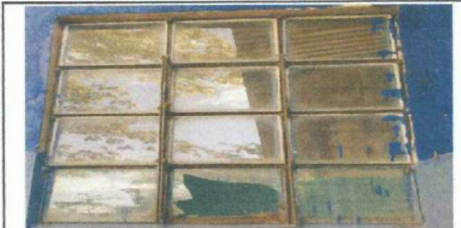
Foto 6: Se observa que las ventanas del centro educativo se encuentran en mal estado, presentando deterioro en su estructura, marcos dañados y cristales rotos.
